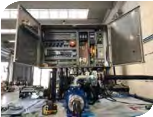
Pannello di controllo elettrico
